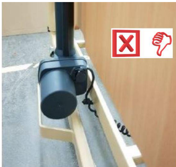
Неправильная прокладка кабеля для Dali low-entry / low-entry-econ
